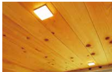
室内LED照明(天井)
